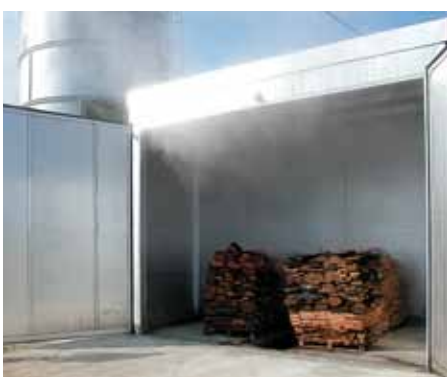
Equipos de vaporizacion
